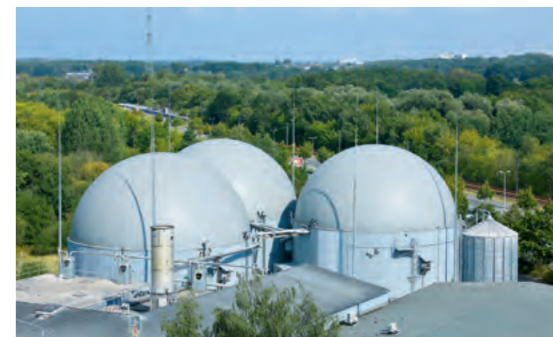
Die Biogasanlage in Schwerin wird mit 75 % Maissilage und 25 % Roggen-Ganzpflanzensilage (GPS) betrieben.
