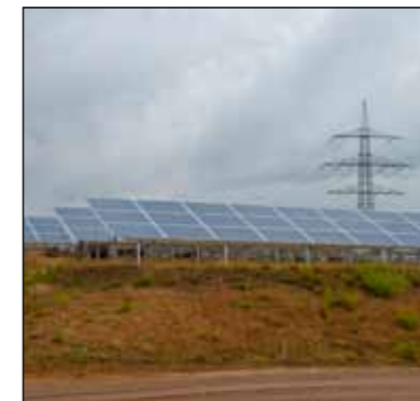
Ausschnitt der Photovoltaik-Anlage aus südwestlicher Richtung Foto: maxpress/jk
