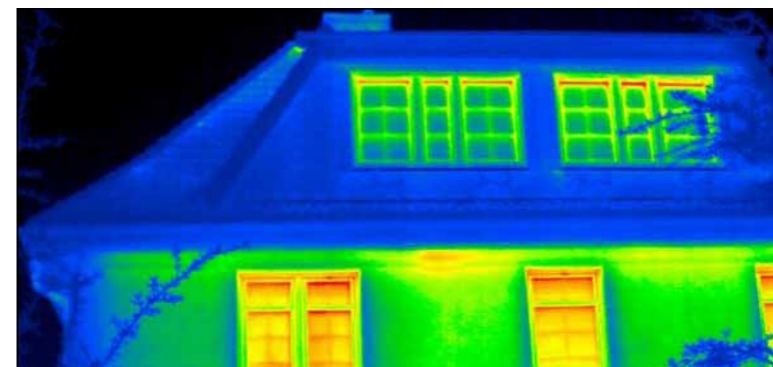
Die rötlichen Stellen im Wärmebild zeigen ganz deutlich, wo das Haus Wärme verliert und wo sich möglicherweise Baumängel befinden Foto: SWS
