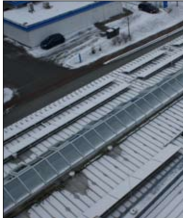
Auf dem städtischen Dach betreiben die Stadtwerke Schwerin die neue Fotovoltaikanlage Foto: SWS
