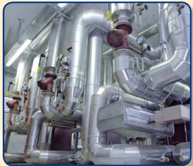
Blick in eine Fernwärmestation.
