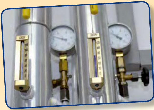
Messinstrumente in der Fernwärmestation.
